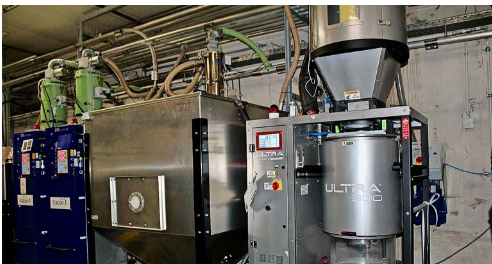
Bevor die Kunststoffe über den automatisierten Kupplungsbahnhof den Spritzgießmaschinen zugeführt werden, werden sie getrocknet – unter anderem in einem neuen Vakuumtrockner.
